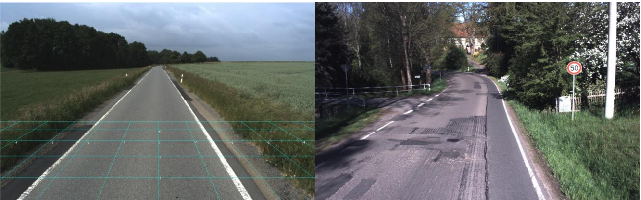
Abbildung 18: S 195 im östlichen Abschnitt 4946038 bis 4946055 in Station 2266 mit stark beschädigten Randbereichen sowie Ausbesserungen, im Abschnitt Dittmannsdorf 4946050 bis 4946051 in Station 855 mit massiven Substanzschäden und ausgefahrenen Randbereichen
