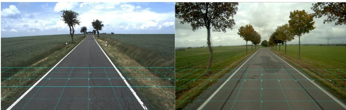
Abbildung 17: S 196 im nördlichen Abschnitt 4946001 bis 4946016 in Station 414 mit starken Beschädigungen im rechten Randbereich, im südlichen Abschnitt 4946051 bis 4946002 in Station 1926 mit Schäden an Fahrbahn sowie ausgefahrene Bankette
