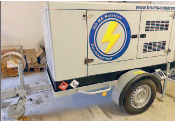
Niederspannungsersatzanlage (NEA) der Fa. HO-MA
