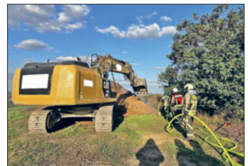
Ein Bagger des Betreibers hat beim Auseinanderziehen des Brandguts unterstützt. So konnten auch verborgene Schichten effizient abgelöscht werden.
