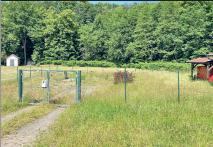
Blick auf das Pumpwerk Freiberger Straße – Mohorn
