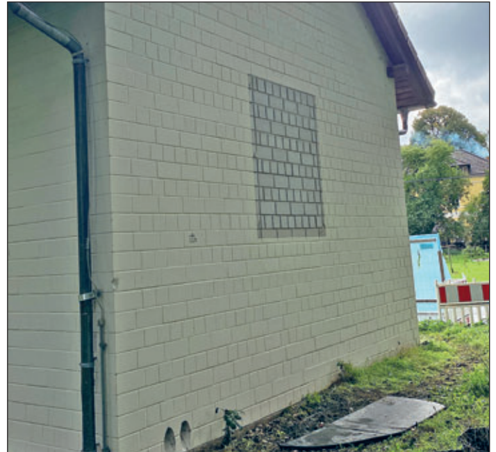
Verschlossene Wanddurchführung (Lüftungsgitter der stationären Netzersatzanlage)
