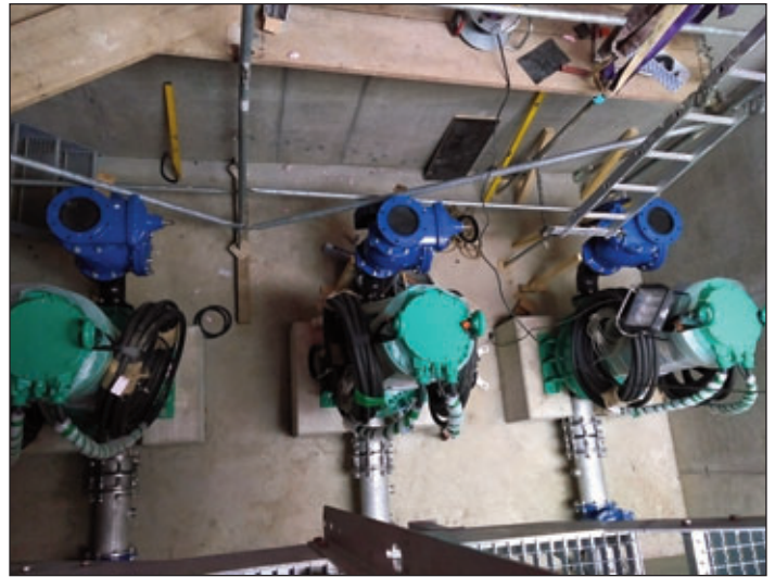
Diese Pumpen befördern seit Januar 2019 das Abwasser nach Dresden, Aufnahme während der Montage im November 2018 (Foto: SEDD)
